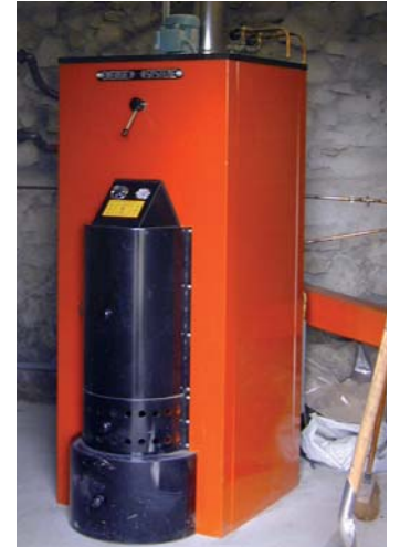
Chaudière à bois pour des logements sociaux à Cadarcet (Ariège)
